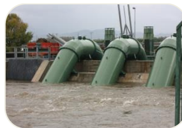
GESTIONE E MANUTENZIONE ORDINARIA E STRAORDINARIA DI IMPIANTI IDROVORI, PARATOIE, SISTEMA IRRIGUO, INVASI ARTIFICIALI
